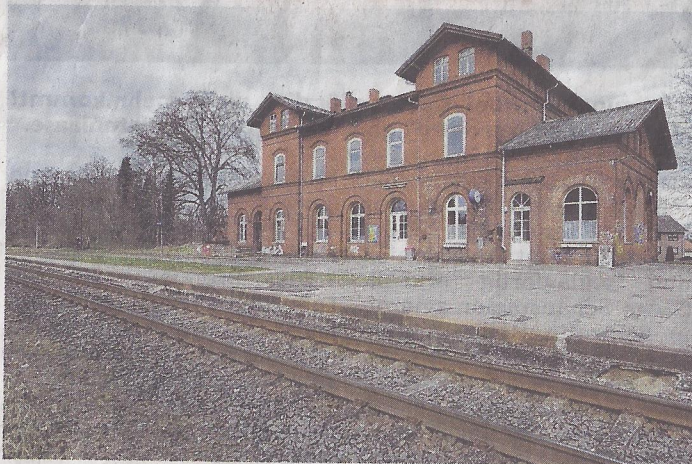
Ein attraktives Gebäude, an welchem der Zahn der Zeit aber schon erheblich genagt hat: Der Bahnhof Hitzacker.
